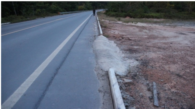
Figura 8 - Acesso irregular na rodovia BR-174/AM.
