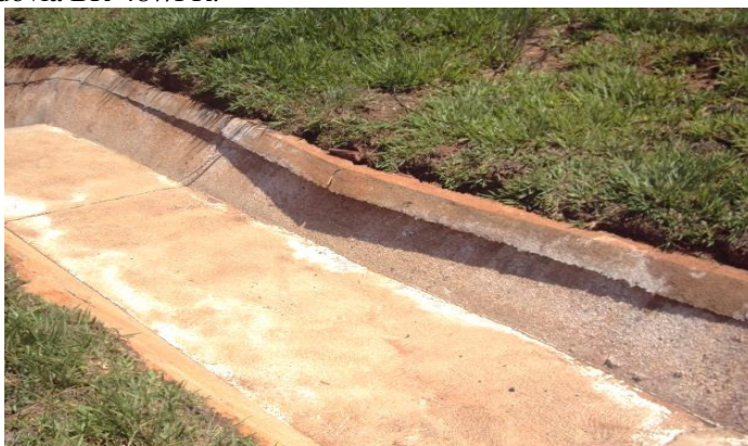
Figura 29 - Erro de dimensionamento na execução da sarjeta de aterro na rodovia BR-487/PR.
