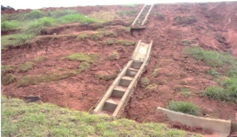
Figura 39 - Escorregamento em corte na rodovia BR-487/PR.
