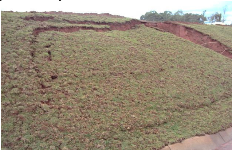
Figura 40 - Escorregamento em corte na rodovia BR-487/PR.
