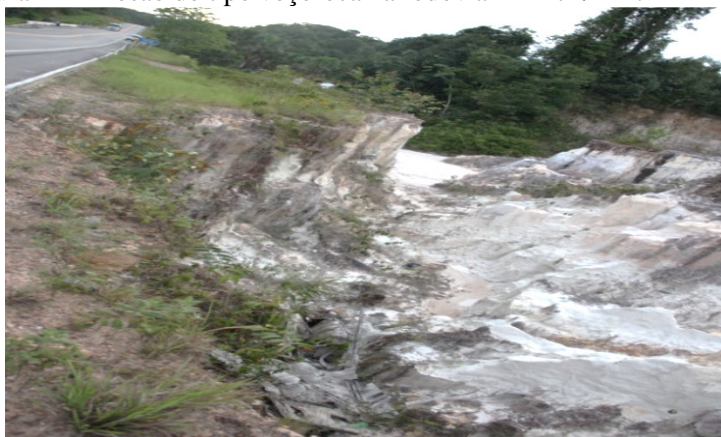
Figura 21 - Erosão do tipo voçoroca na rodovia BR-174/AM.
