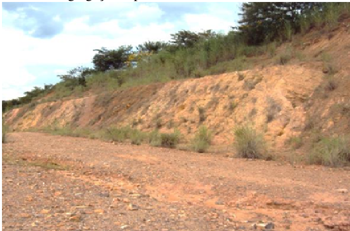
Figura 17 - Desagregação superficial na rodovia BR-135/BA.
