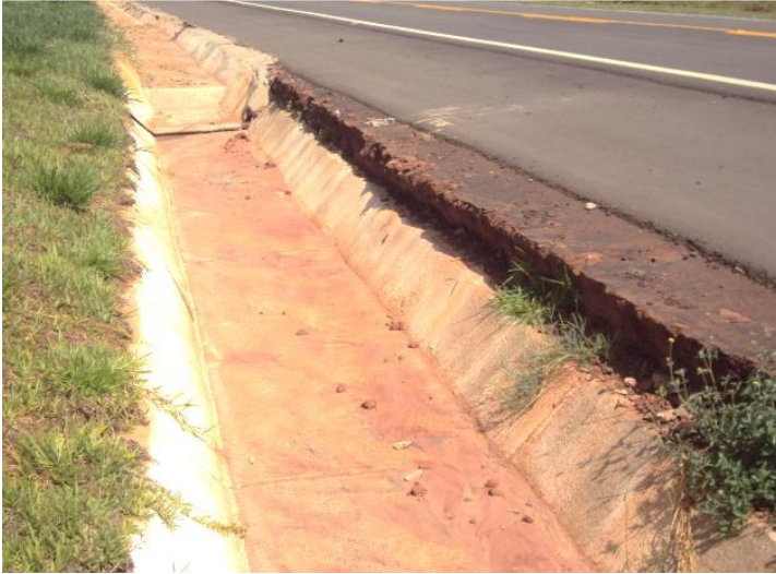
Figura 22 - Erosão longitudinal na plataforma da rodovia BR-487/PR.
