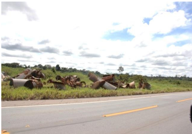
Figura 44 - Ocupação da faixa de domínio com material de descarte na rodovia BR-174/AM.
