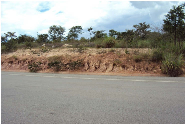
Figura 18 - Erosão em sulcos na rodovia BR-135/BA.
