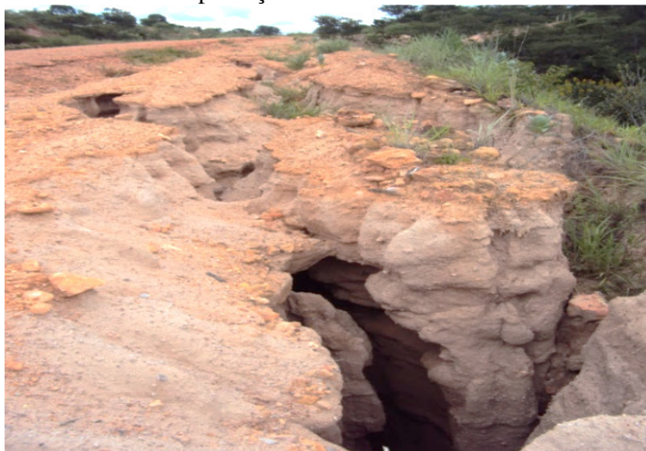
Figura 20 - Erosão do tipo voçoroca na rodovia BR-135/BA.
