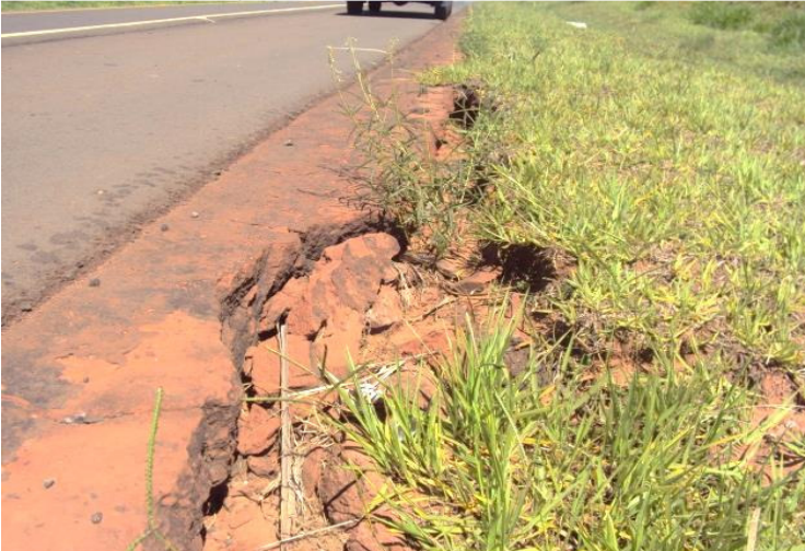
Figura 23 - Erosão longitudinal na plataforma da rodovia BR-487/PR.
