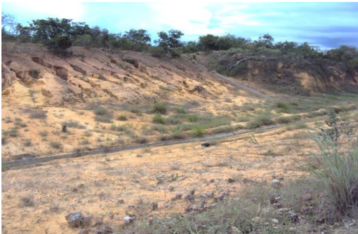
Figura 19 - Erosão em ravinas na rodovia BR-135/BA.
