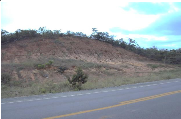
Figura 27 - Erosão diferenciada na rodovia BR-135/BA.
