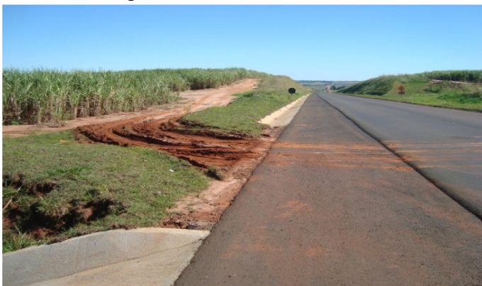
Figura 9 - Acesso irregular na rodovia BR-174/AM.
