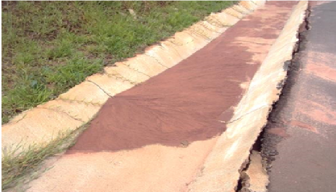
Figura 11 - Acúmulo de sedimentos nos dispositivos de drenagem na BR-487/PR.
