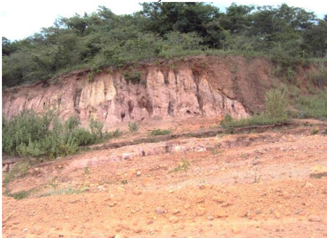
Figura 24 - Erosão interna ao maciço na rodovia BR-135/BA.
