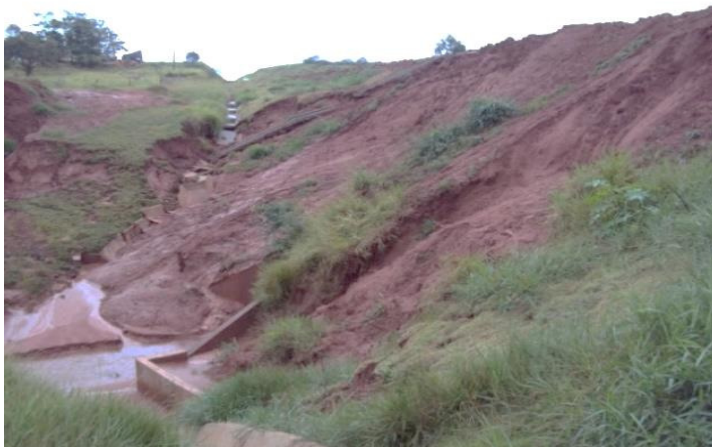
Figura 33 - Escorregamento em aterro na rodovia BR-487/PR.
