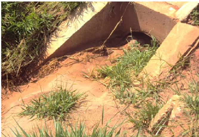
Figura 14 - Assoreamento do sistema de drenagem na rodovia BR-487/PR.
