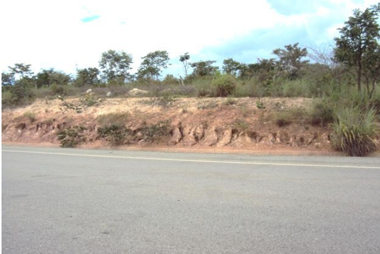
Figura 26 - Erosão diferenciada na rodovia BR-135/BA.
