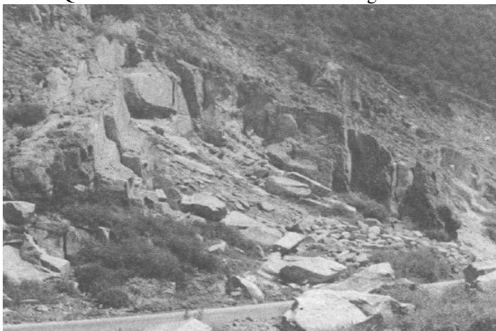
Figura 45 - Queda de blocos em taludes de rochas ígneas.
